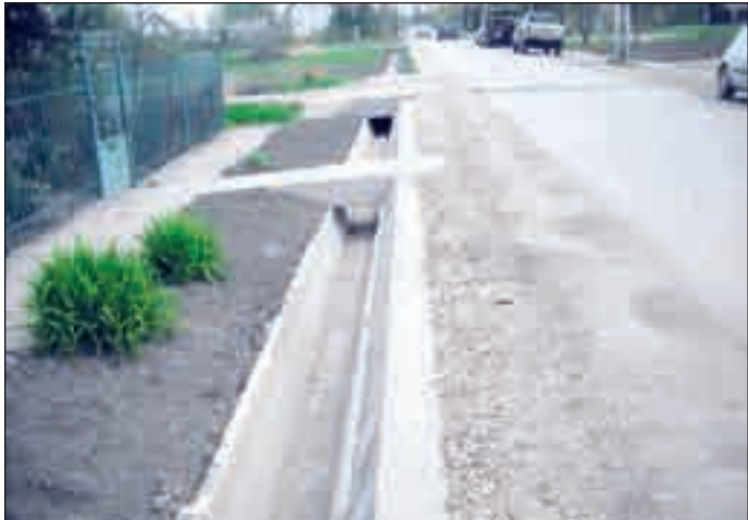
Betonozott árok vezeti el a csapadékot a Sulák patak medrébe
