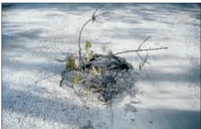
szabálysértési eljárás indulhat azon kivitelezők ellen, akik nem teszik biztonságossá az utakat – képiükön egy beszakadt utcarész látható, hetekig csupán egy leszúrt ág jelezte a veszélyt, míg az üreget be nem tömteék
