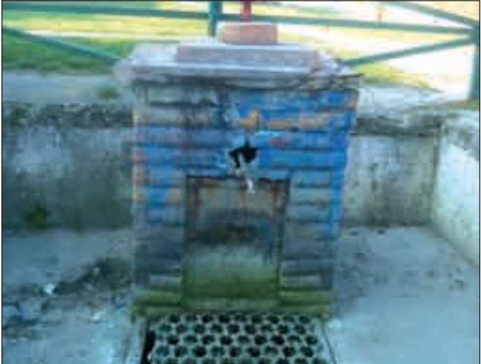
A kútból sem folyik a víz, még a csap nyitó-záró elemét is leszerelték
