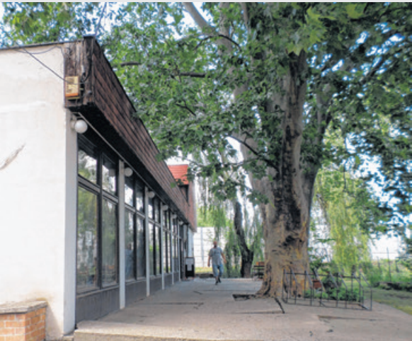
A vén platánfa remek hűvöst ad nyáron, és ékesíti a könyvtárat, de a hosszú évek alatt a gyökerei megrongálták a terasz betonburkolatát. Akadálymentesítésre is szükség van a lépcsőnél. A nyári szünetben új burkolatot kap a bejárat.
