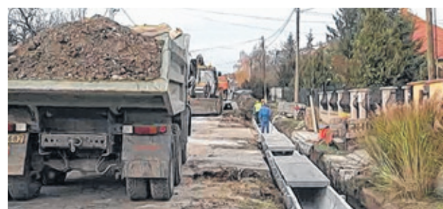
Még zöldhulladékot sem szabad a vízvezető árokba seprni
