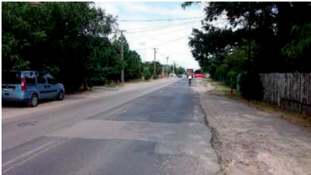
33. ábra – A Szováti út keresztmetszete és állapota 7 m-es burkolatszélesség, de nincs járda sem.
