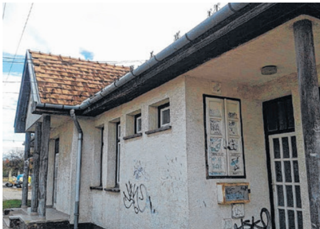
Az épület állapota mostanra szinte teljesen leromlott
