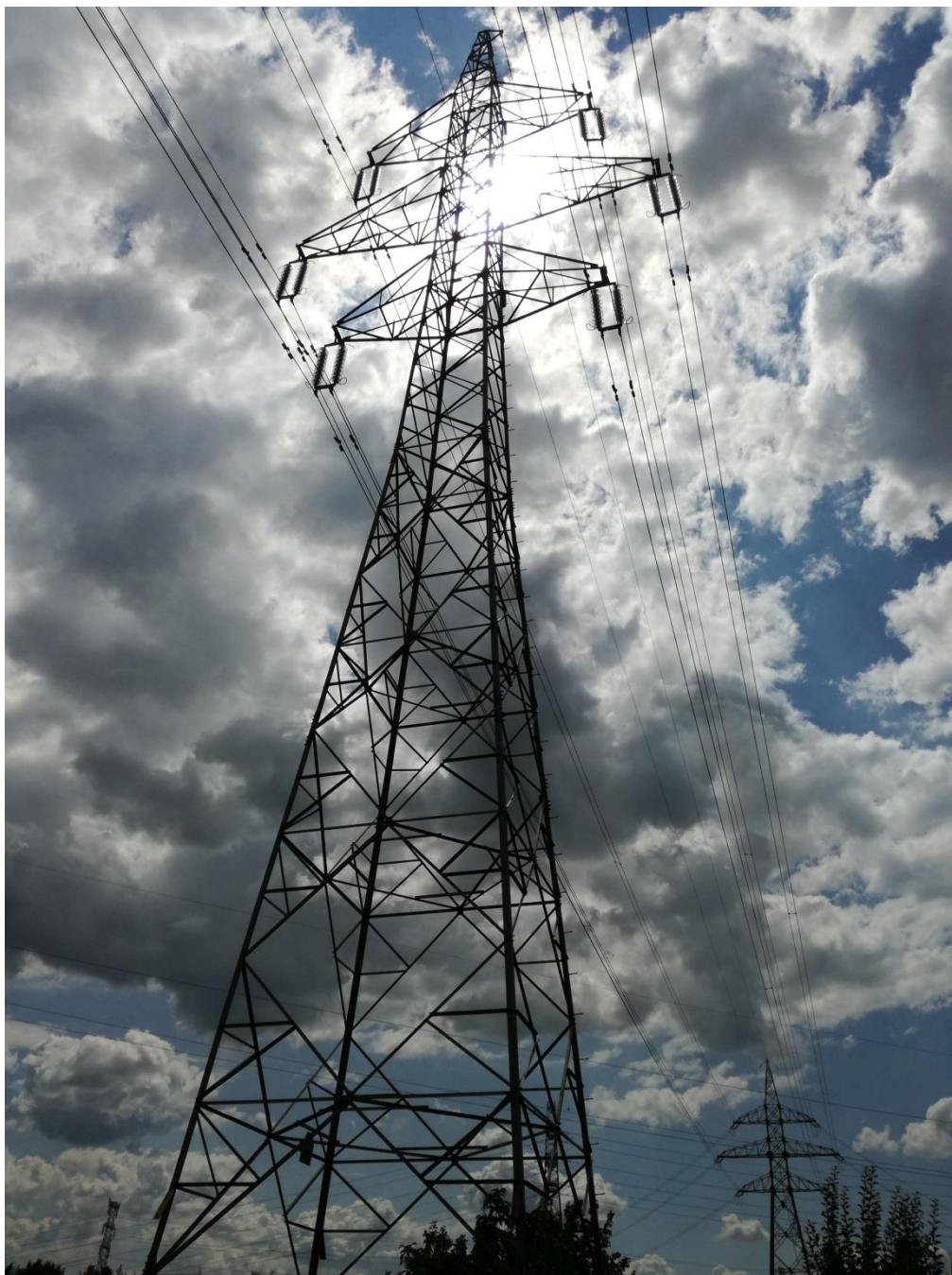
26. ábra: a telek Júlia utcai részén lévő 132 kV villamosvezeték tartóoszlopa
