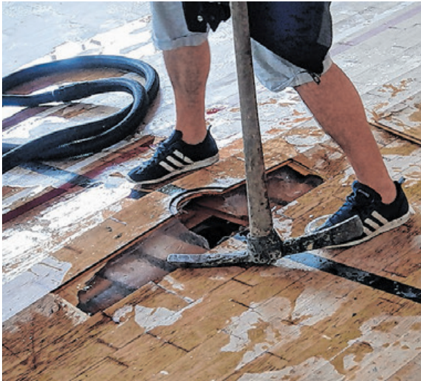
Hat-nyolc köbméter víz árasztotta el a tornacsarnokot
