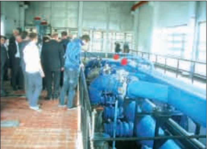
A vízműtelep szivattyúi frekvenciaváltós vezérlést kapnak a projekt keretében
